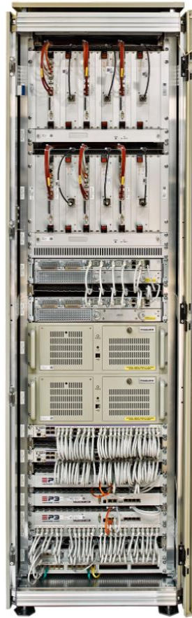
Рисунок 4.4 – Стойка с оборудованием ЦРБ
