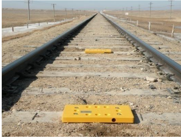
Рисунок 4.7 – Установленные бализы на железнодорожном перегоне
